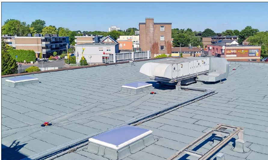
Bild 2: Insgesamt sechs ROOFGUARDS mit FLECK connect wurden auf dem Flachdach mit einer Größe von 2.400 m 2 verbaut. Auf dem Bild sind insgesamt drei Stück zu sehen.
